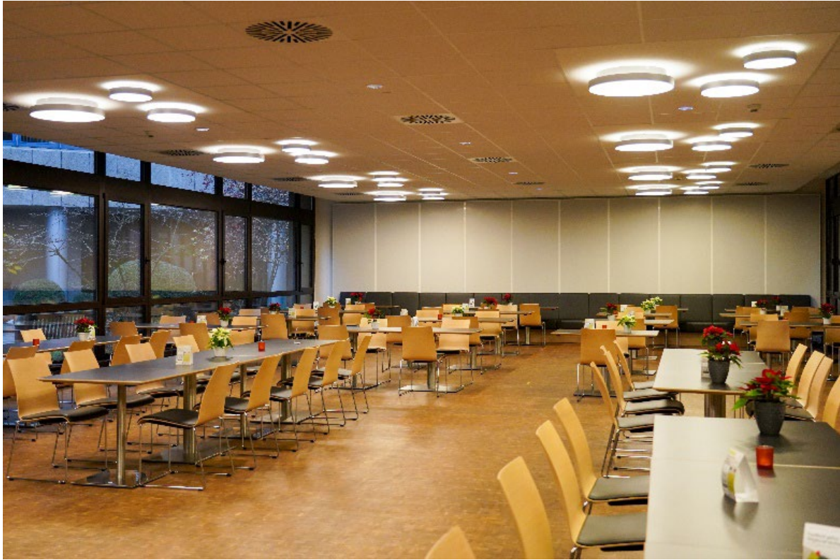
Abbildung 17: Kantine der BGN-Hauptverwaltung mit abgehängter Akustikdecke und schallabsorbierenden Elementen an der hinteren Wand im IST-Zustand
