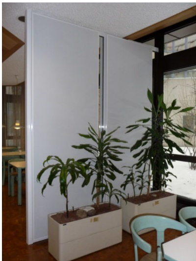
Abbildung 12: Schallabsorber als Schwerter im Raum mit Glasscheibe im Zwischenraum
